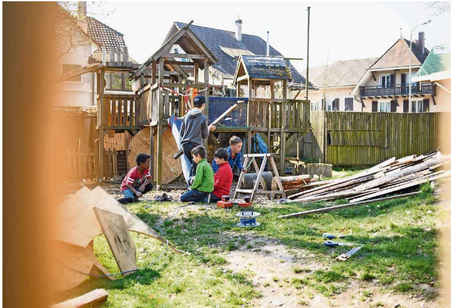
Auf dem Spielplatz Güggi mussten Sturmschäden durch entwurzelte Bäume behoben werden. MICHEL LÜTHI
